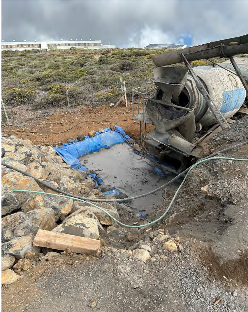
Balsa de lavado del hormigón
