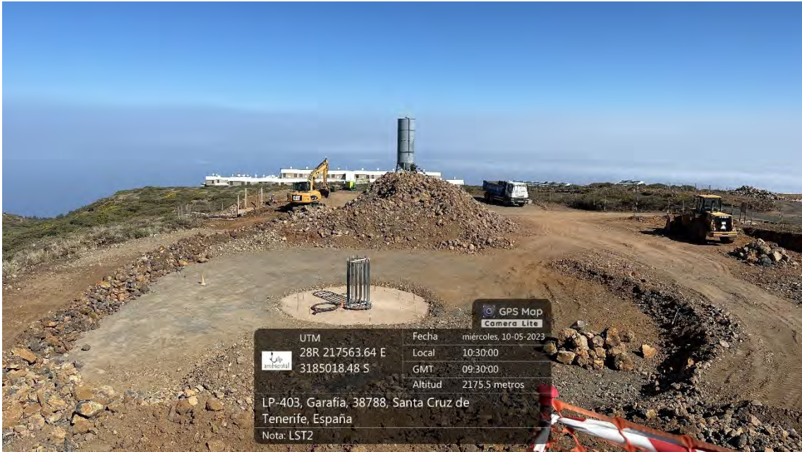
Plataforma LST2, jaula del núcleo central de apoyo del futuro telescopio y comienzo desmante y nivelado de la plataforma definitiva
