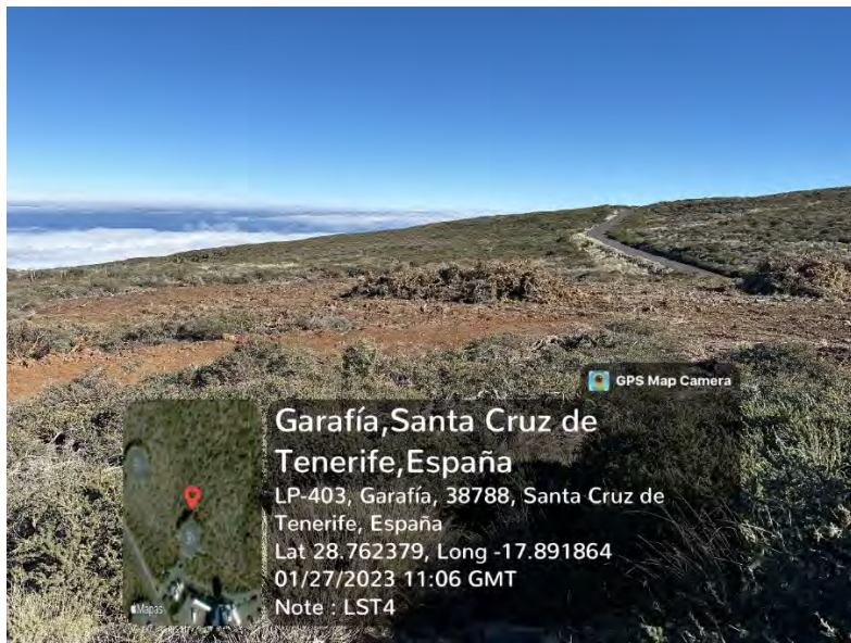
Zona LST4 donde se aprecia la apertura del acceso y el acumulo de los codesos para su retirada
