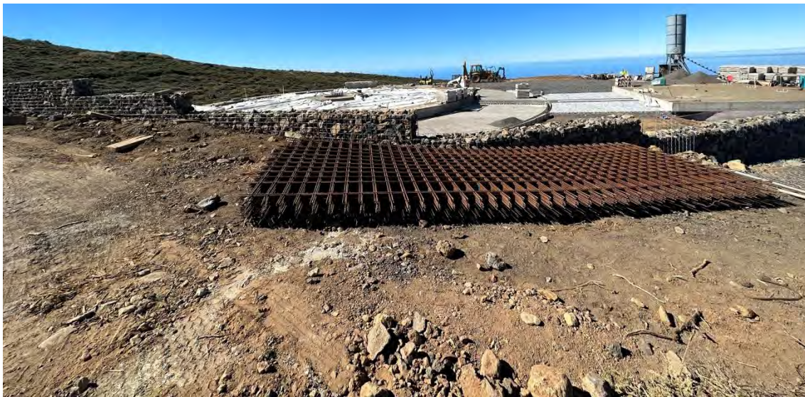
Vista plataforma LST2
