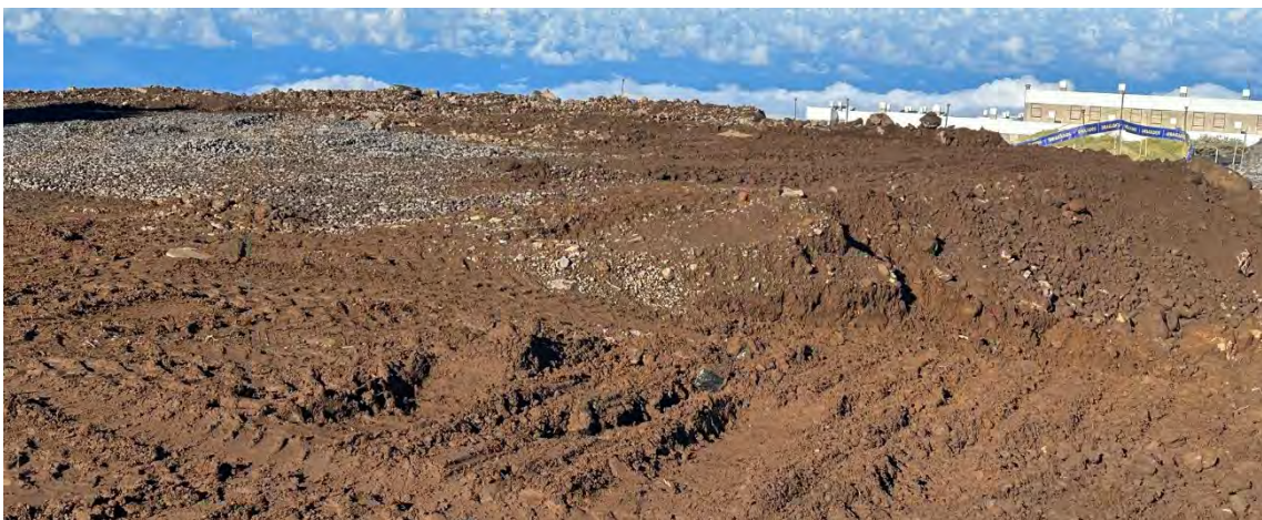
Extendido plataforma auxiliar LST2
