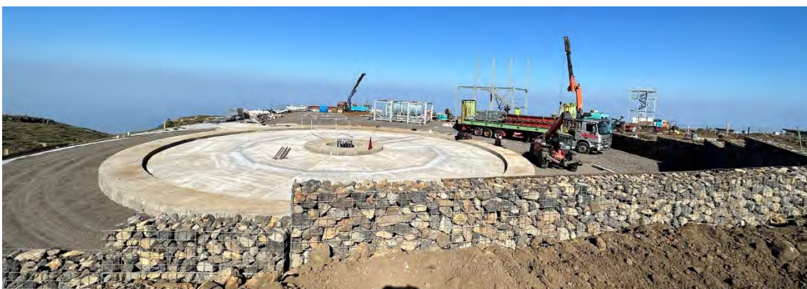
Vista plataforma LST2
