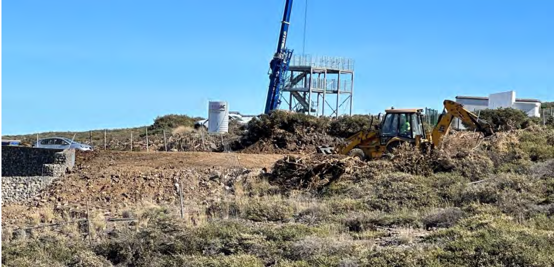
Detalle del trabajo sobre la zona de amortiguación por la parte hacia el sendero.
