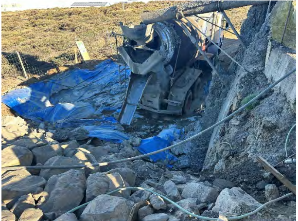
Balsa de lavado en hormigonera
