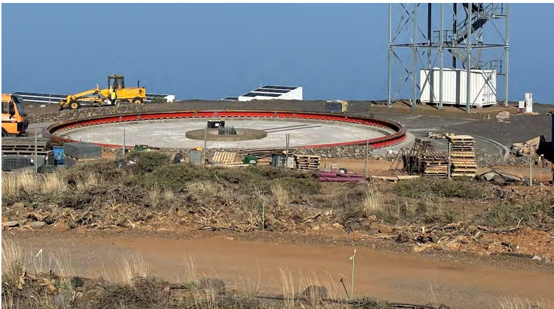
Vista LST3, donde se observa el acceso al LST4 y la inexistencia del vallado.
