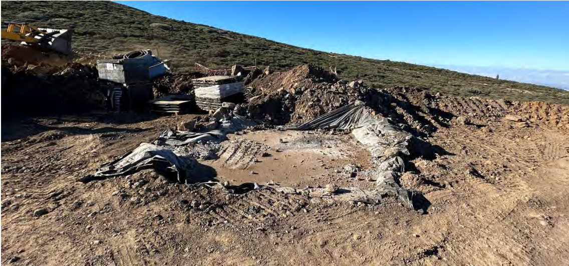
Balsa de lavado de las canaletas, ya colmatada y lista para cambiarse.
