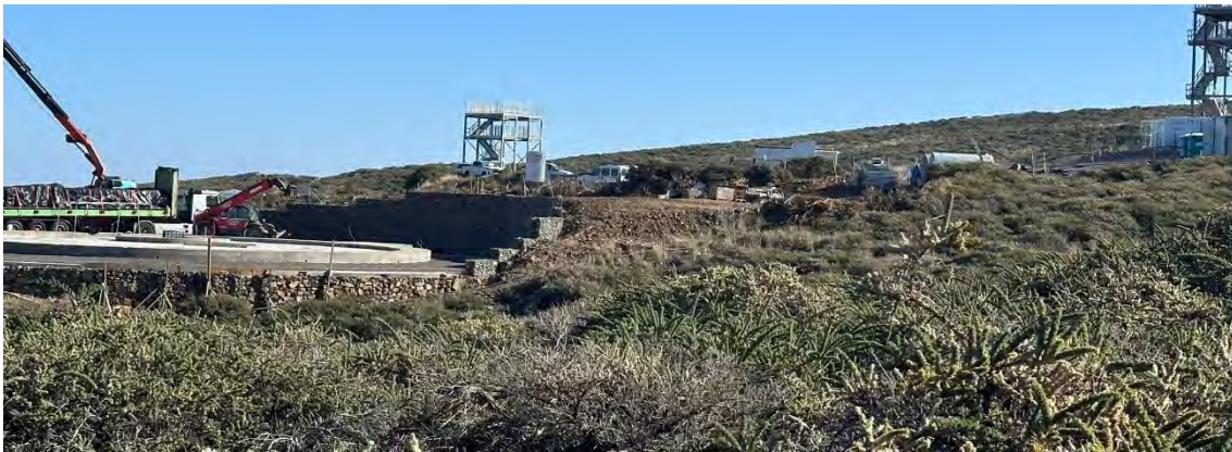
Vista desde el sendero del LST2. En la parte superior se observa terraplenado de la zona de amortiguación.
