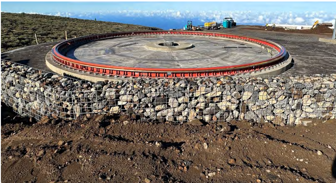
Vista plataforma LST2
