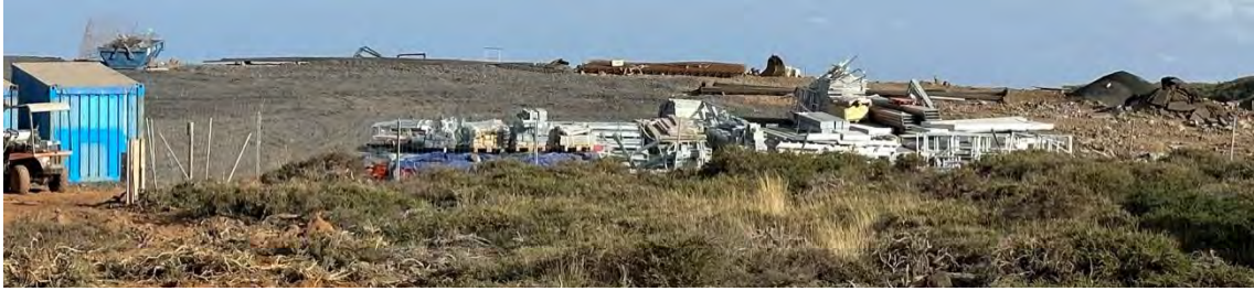
Vista plataforma auxiliar LST3 con el material de montaje para el futuro telescopio.
