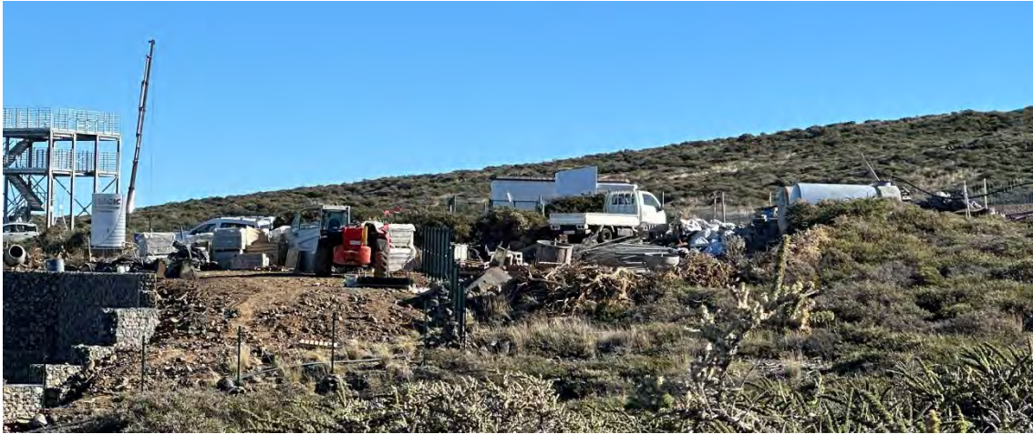
LST2 visto desde el sendero, se aprecia el acopio de residuos.
