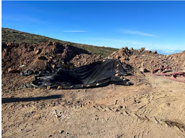
Balsa de lavado canaletas
