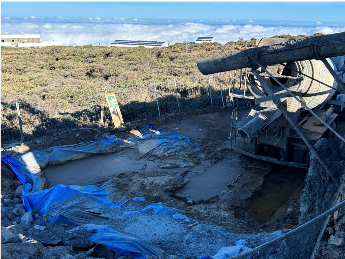
Balsa de lavado de la hormigonera.
