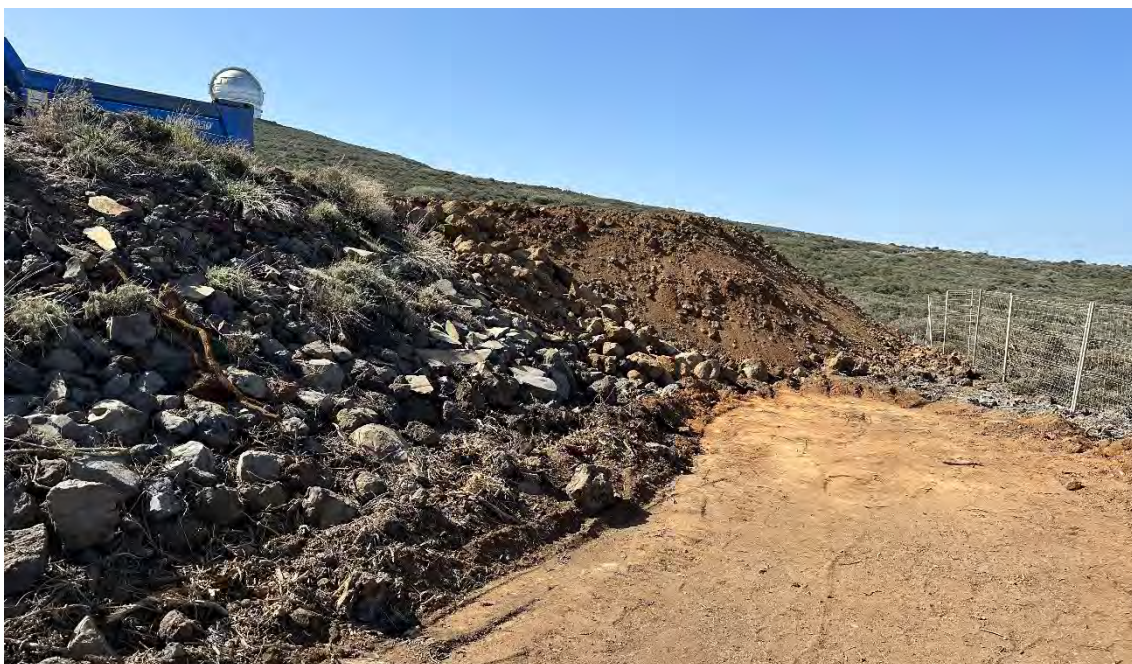
Conformación plataforma auxiliar LST2, se observa vía de acceso donde entraran los camiones a recoger el hormigón para la realización de las plataformas de los telescopios. En la parte superior se dispondrá la hormigonera.
